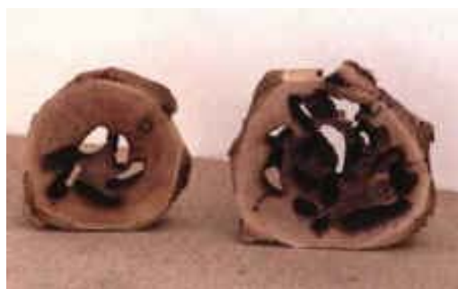
Fig. 9 y 10: Daños producidos por Cerambix cerdo
